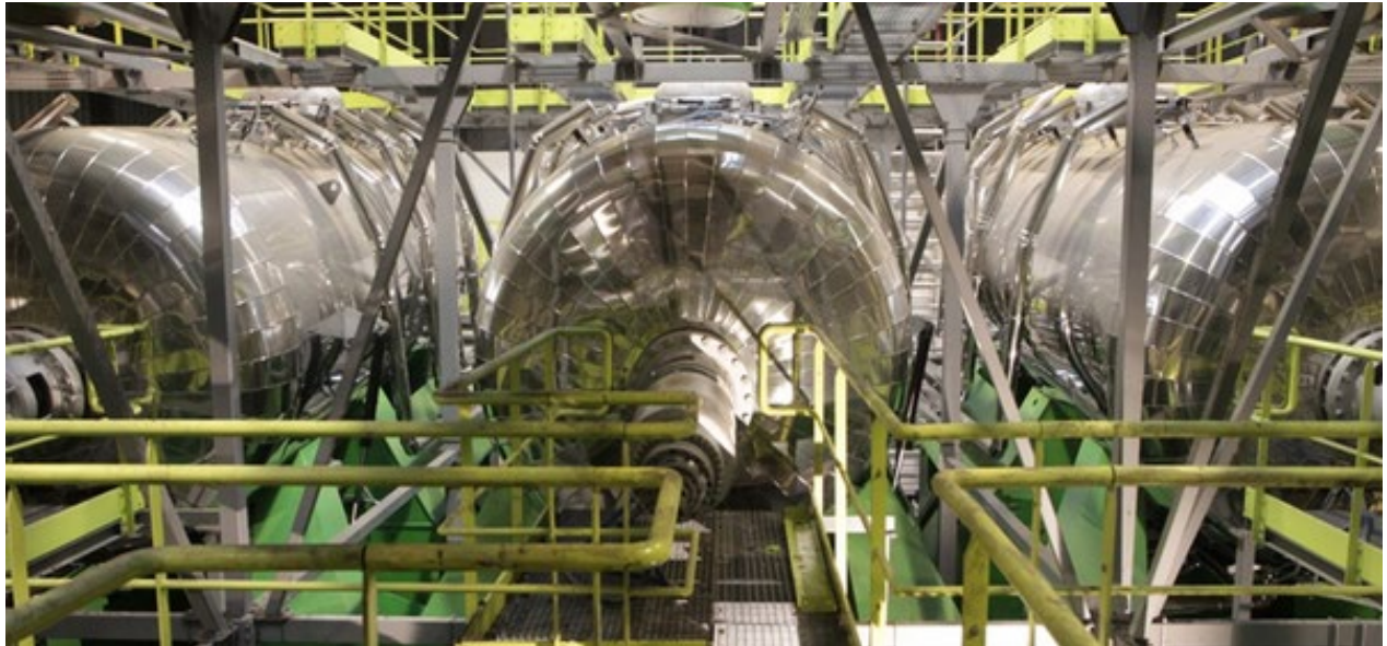
Obr. 12: Skupina parných autoklávov RotoSTERIL BEG7000 na obdobnej prevádzke
